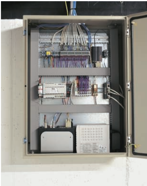
Viele Datenpunkte auf engem Raum: Das Wago-IO-System (mittlere Schiene rechts) beansprucht wenig Platz
